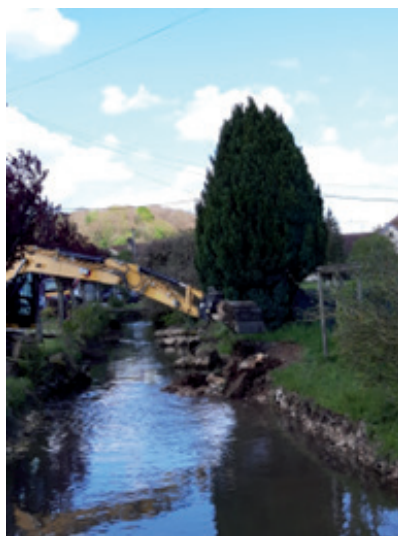
Ruisseau des Roises à Greux- Travaux de réalisation des banquettes végétalisées – mai 2024
